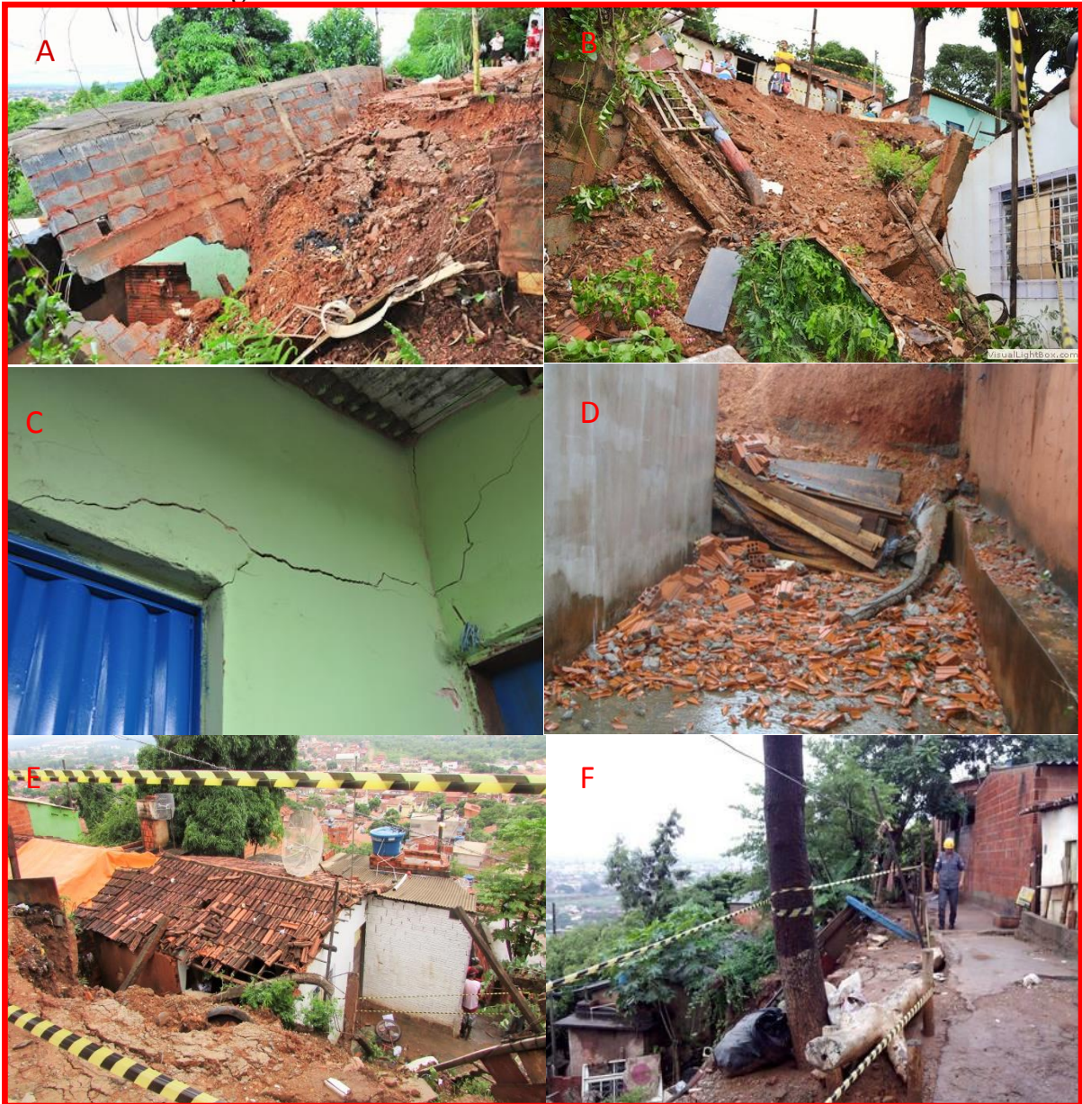
Figura 12 - Deslizamentos na Vila São Francisco de Assis
