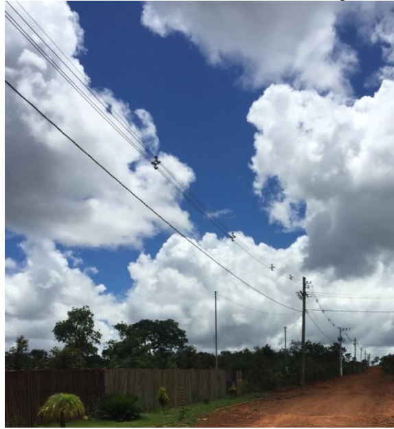
Figura 12: Rua do chacreamento com Iluminação da CEMIG
