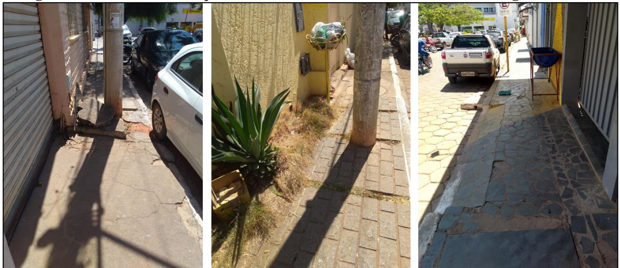
Figura 27 - Estado das calçadas das ruas Guarda Mór Alkmim e Cônego Moreau
