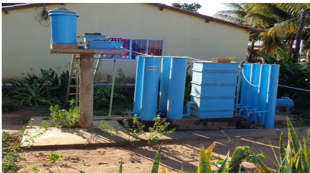
Foto 6: Estação de tratamento de água
