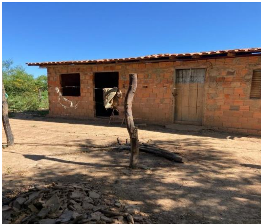
Foto 03: Barracão do Gilvan. Nota-se uma construção simples e inacabada. Serve de suporte para armazenar as colheitas oriundas da sua vazante, e também como local de pouso durante plantio.
