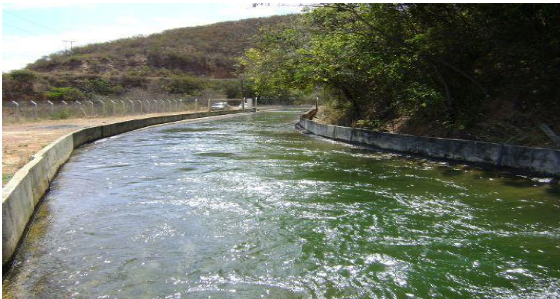
Figura 18: Canal hidráulico no projeto de irrigação.
