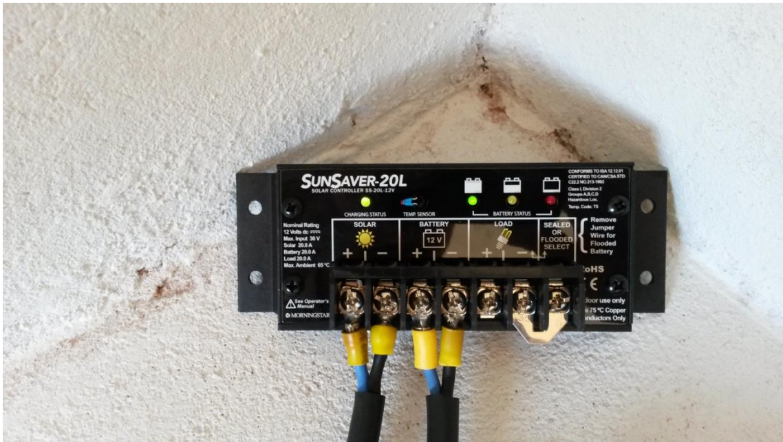
Ilustração 36: Fotografia do controlador de carga
