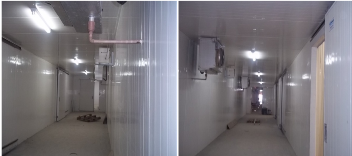
Figuras 30 e 31 – Estrutura da CentralJai alugada – Câmaras Frias
